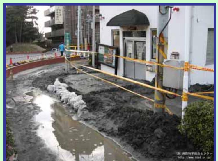
液状化による被害 (千葉県浦安市富岡交番)
