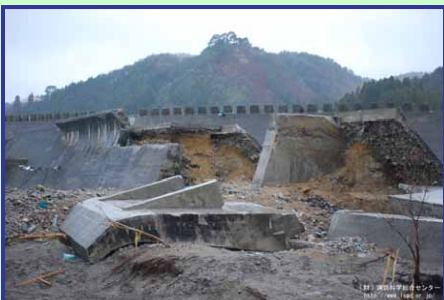
津波で破壊された防潮堤(岩手県宮古市田老地区)
