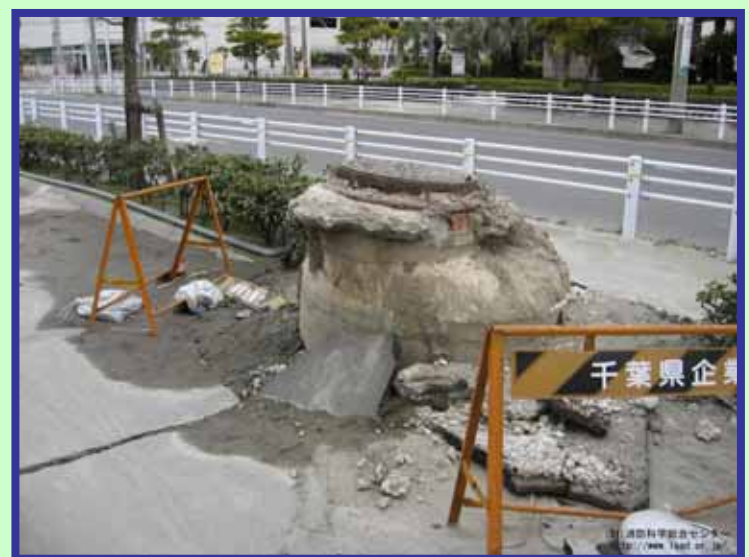
液状化によるマンホール被害(千葉県浦安市)
